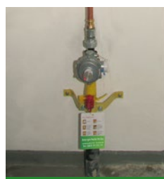
Hauseinführung mit Regelgerät
